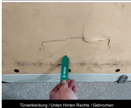
Türverkleidung / Unten Hinten Rechts / Gebrochen
