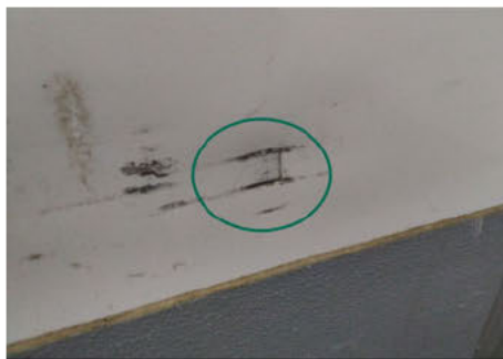
Seitenwand / Vorne / Gebrochen
