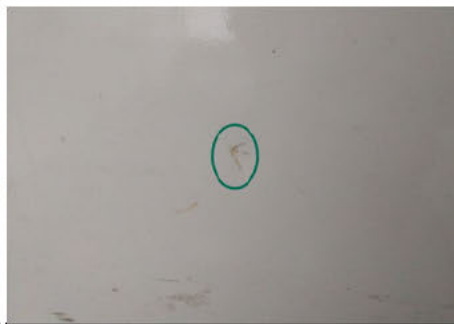
Seitenwand / Vorne / Gebrochen
