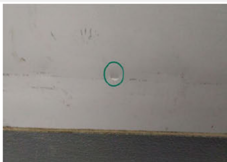
Seitenwand / Vorne / Gebrochen
