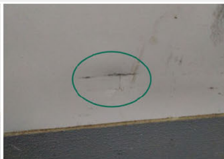
Seitenwand / Vorne / Gebrochen
