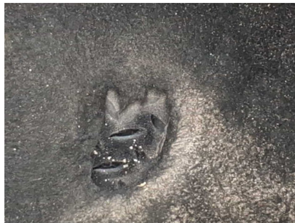
Beschädigung #1: Verkleidungen/Abdeckungen: Fußmatten - beschädigt - erneuern
