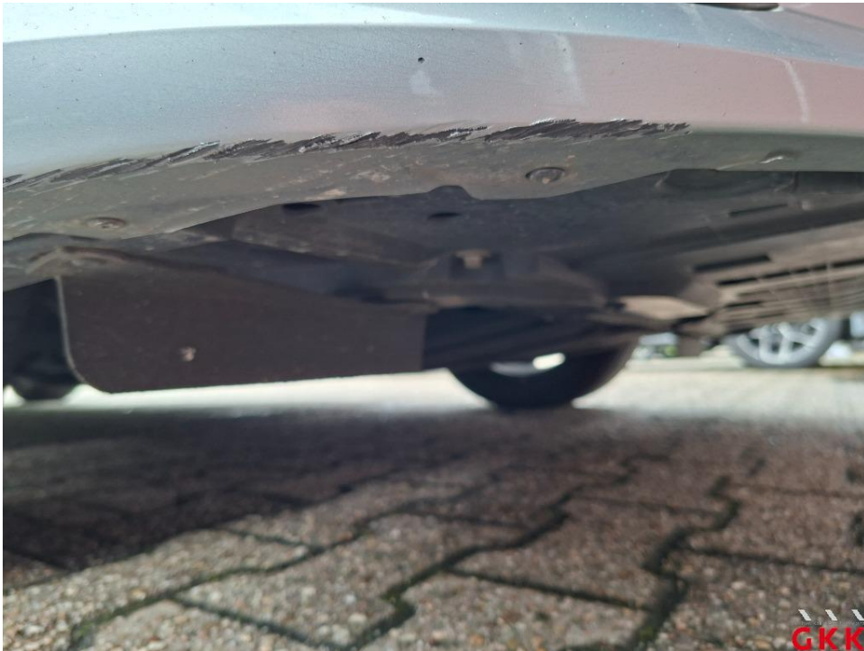
Bild 19. Stoßfänger vorne, Verkleidung unterhalb -lackiert-, verkratzt, Smartrepair
