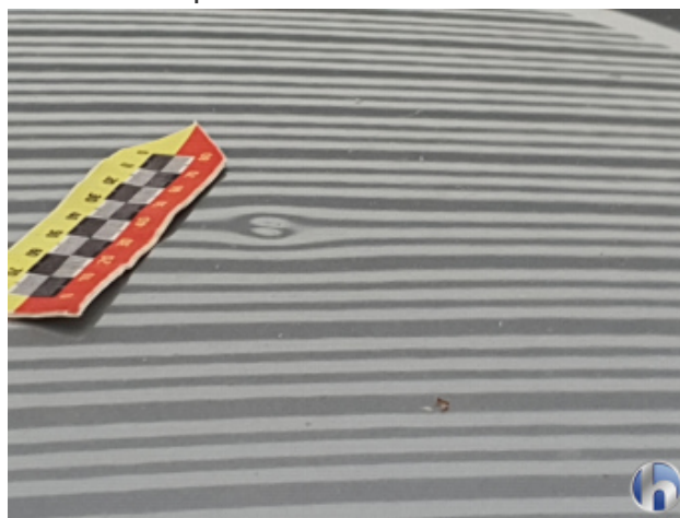
5. Dach 1 Delle - Sanft Instandsetzen
