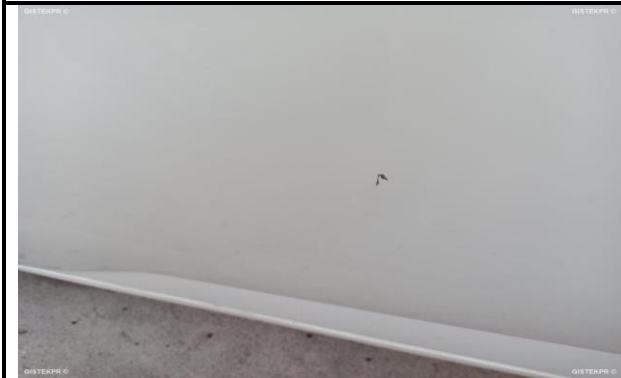
Foto daños externos 1
