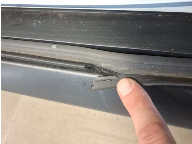
Damage 2: Sliding door, right: Door seal (Unten) - Broken / torn - Replace
