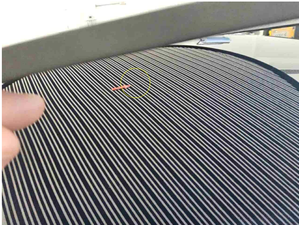
Bild 18 : Dach, mehrfach eingedellt, drücken
