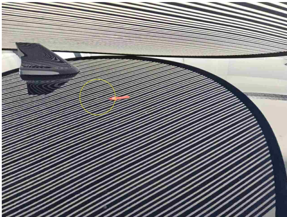
Bild 19 : Dach, mehrfach eingedellt, drücken
