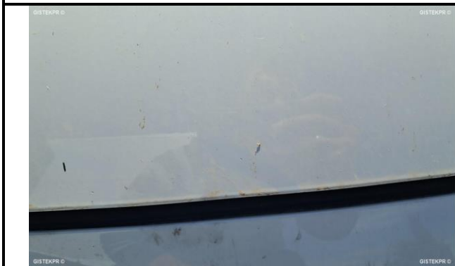
Foto daños externos 1
