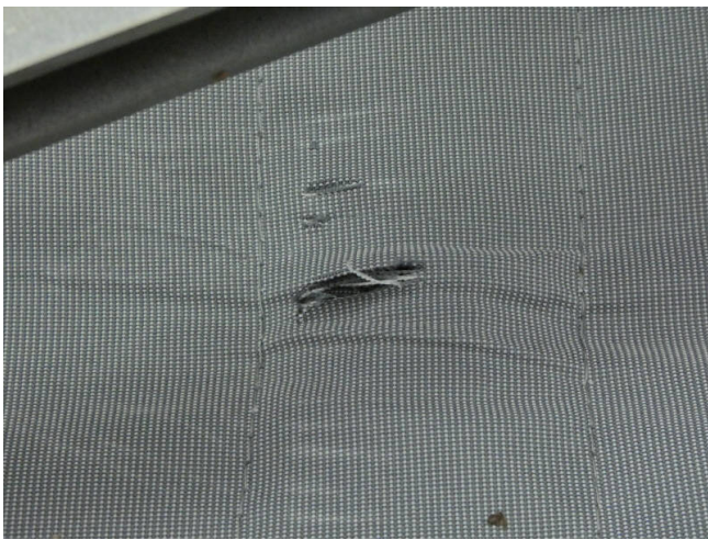
Aufstelltdach Gerissen - Smart Repair
