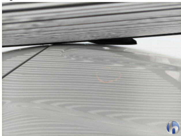
1. Dach Hagelschaden - Sanft Instandsetzen
