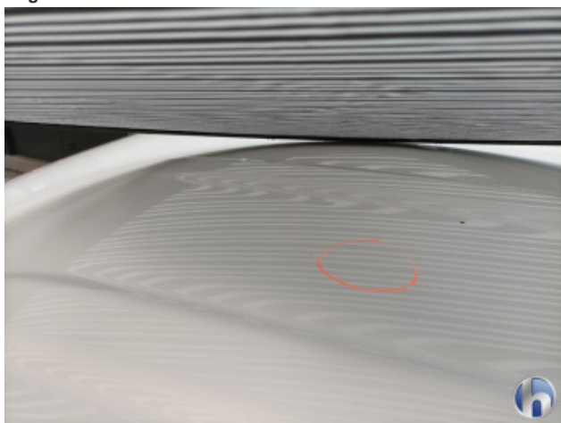
1. Dach Hagelschaden - Sanft Instandsetzen
