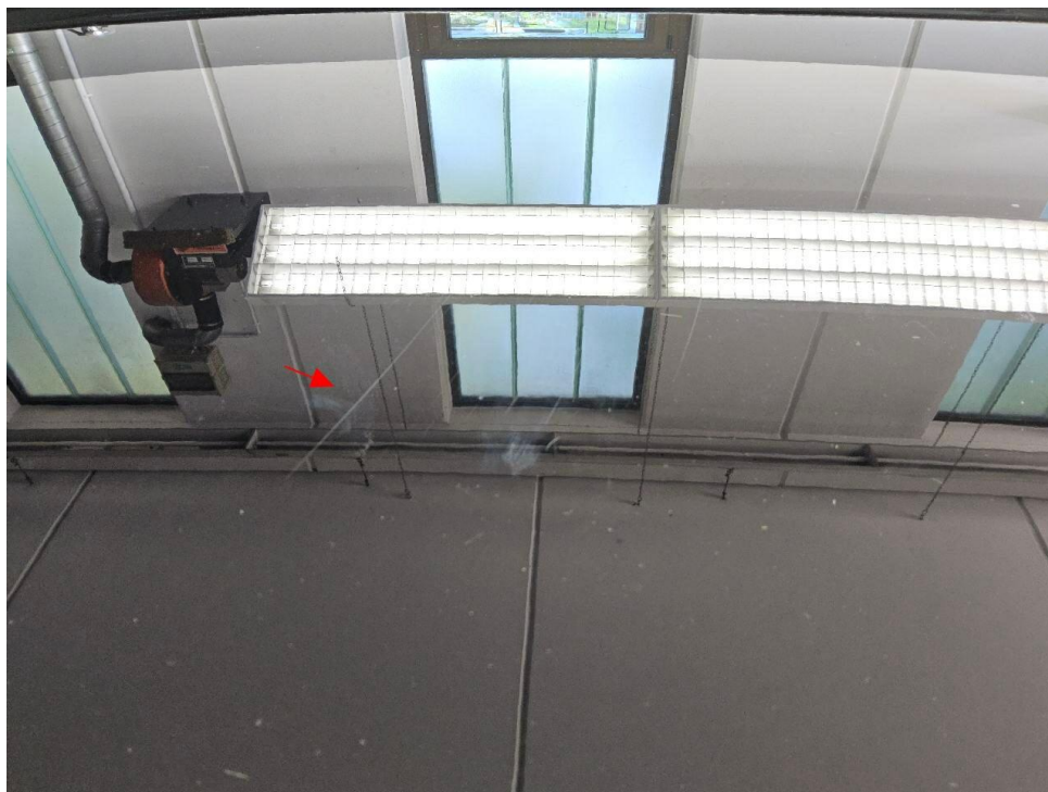
Bild 19 : Dach Lackierung, zerkratzt
