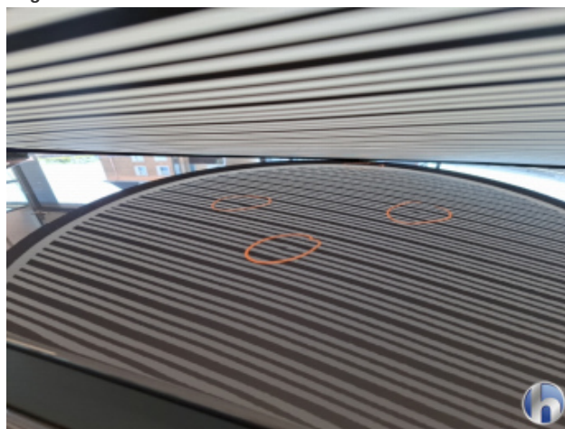
1. Dach Hagelschaden - Sanft Instandsetzen
