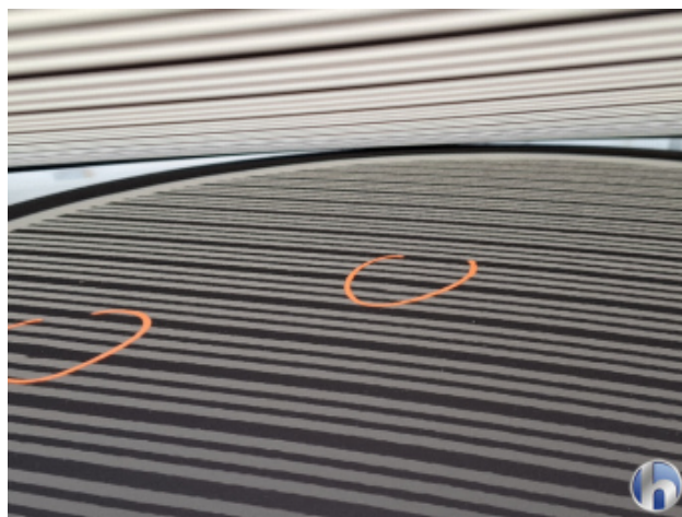
1. Dach Hagelschaden - Sanft Instandsetzen
