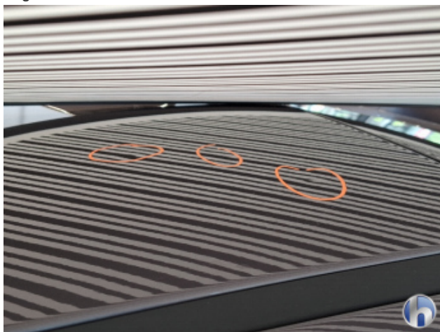
1. Dach Hagelschaden - Sanft Instandsetzen
