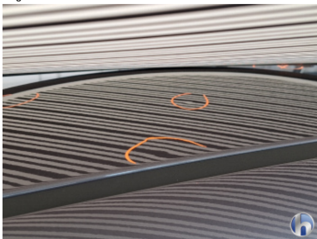
1. Dach Hagelschaden - Sanft Instandsetzen
