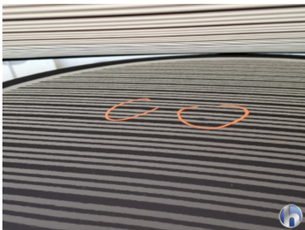
1. Dach Hagelschaden - Sanft Instandsetzen
