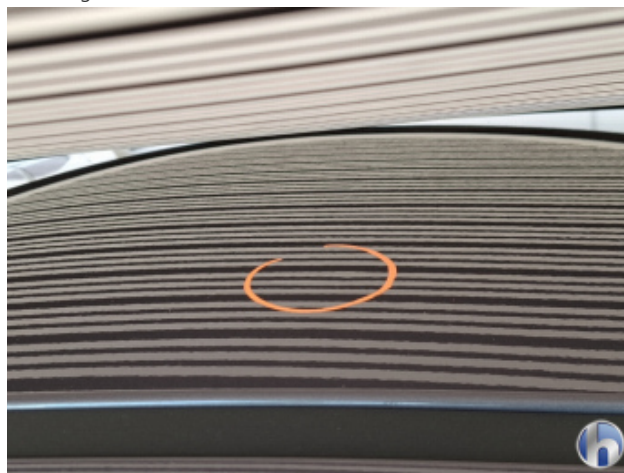
1. Dach Hagelschaden - Sanft Instandsetzen
