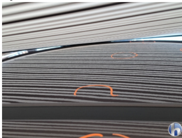
1. Dach Hagelschaden - Sanft Instandsetzen
