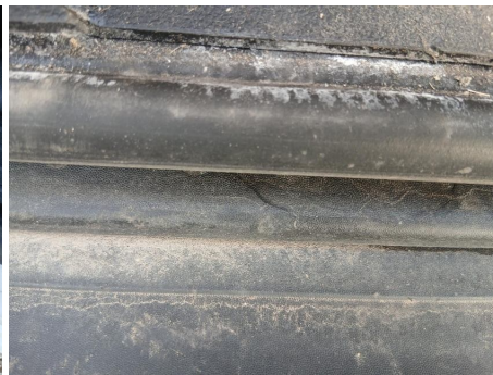
Junta de entrada de puerta / Trasero / Roto
