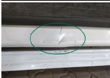
Türeinstieg / Rechts / Delle
