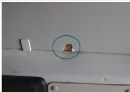
Innenverkleidung Laderaum / Oben Vorne Rechts / Gebrochen
