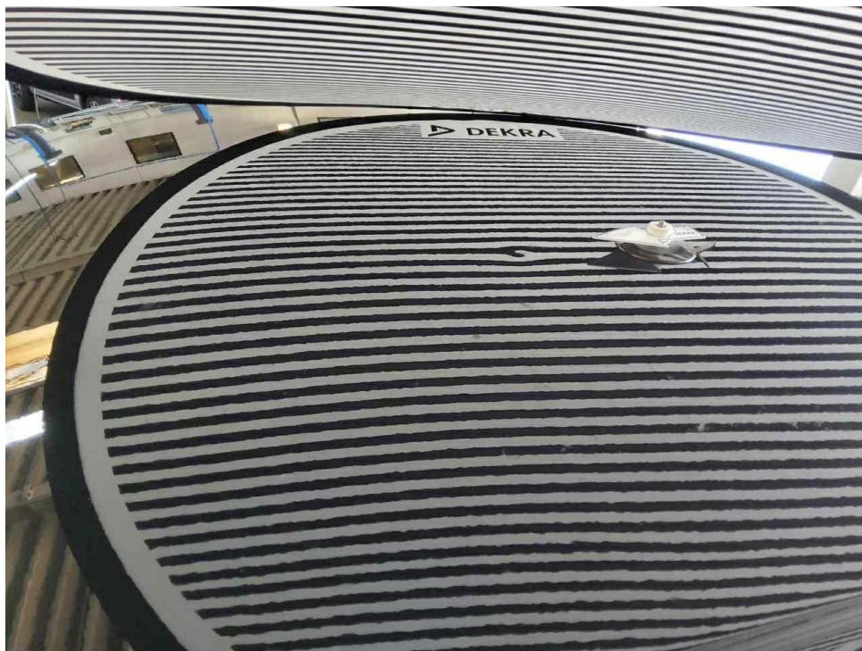
Bild 11 : Dach, eingedellt, drücken
