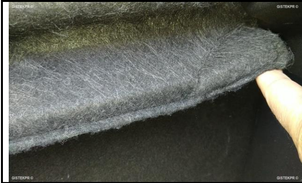
Foto daños internos 39
