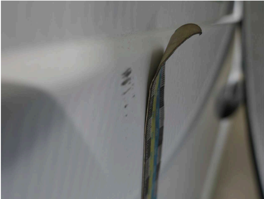
Bild 83 rechte Seite Schiebetür rechts verschürft
