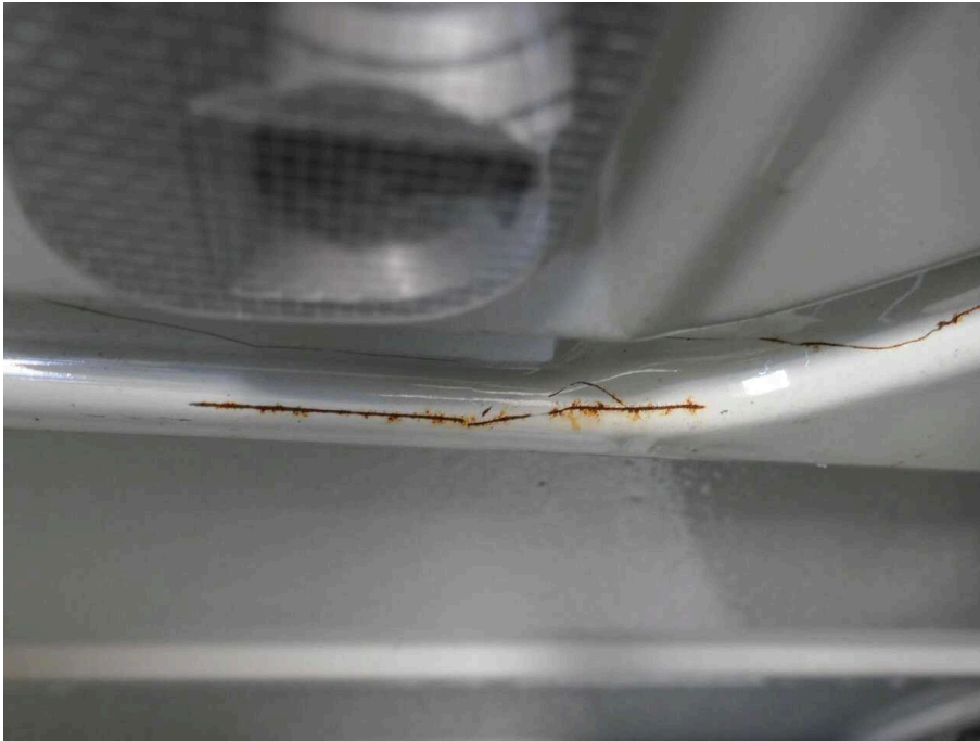
Bild 89 Innenraum Laderaum Decke korrodiert
