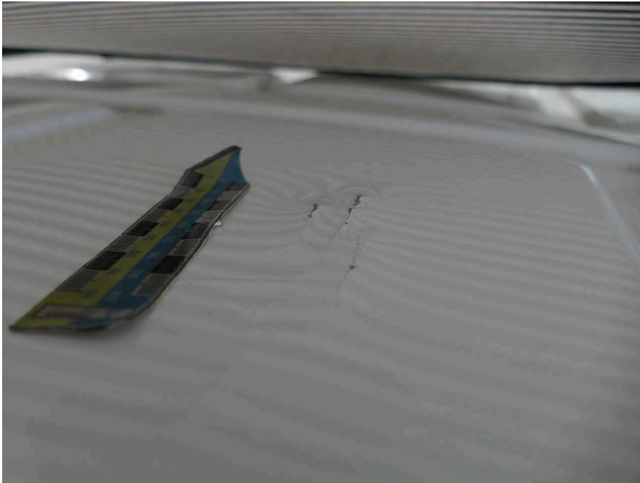
Bild 41 Dach Dachhaut Deformiert/Verkratzt
