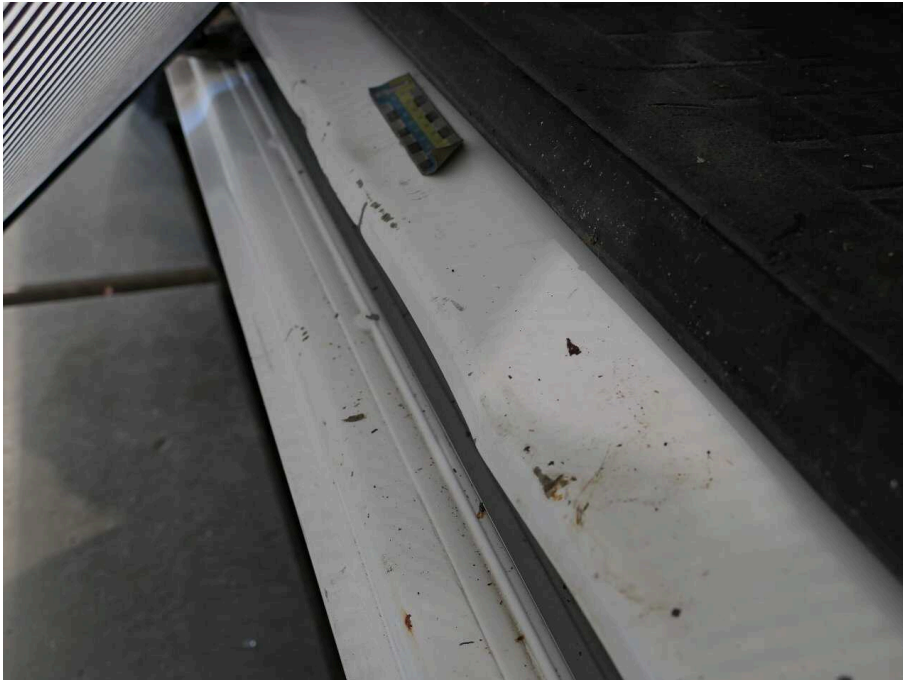
Bild 87 rechte Seite Einstieg Schiebetür rechts eingedrückt
