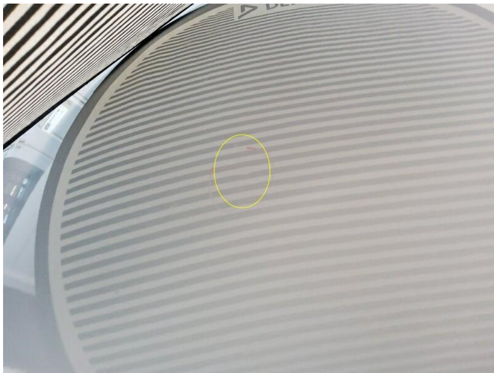
Bild 15 : Dach einzelne kleinere "weiche" Delle
