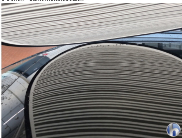
1. Dach 3 Dellen - Sanft Instandsetzen
