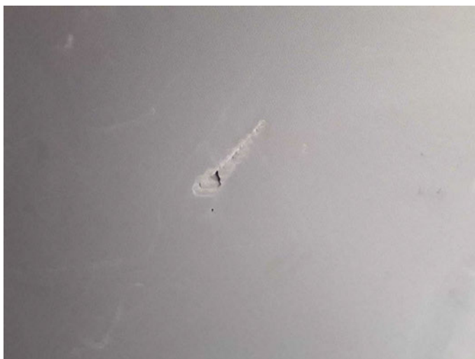
Beschädigung 15: Verkleidungen/Abdeckungen: Laderaumverkleidung rechts - beschädigt - erneuern
