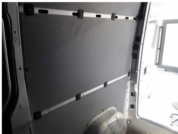
Beschädigung 15: Verkleidungen/Abdeckungen: Laderaumverkleidung rechts - beschädigt - erneuern
