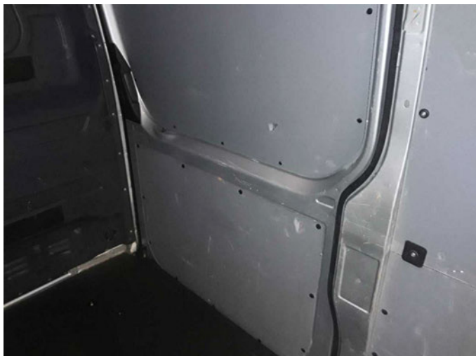
Beschädigung 16: Schiebetür rechts: Verkleidung Sperrholz unten - beschädigt - erneuern
