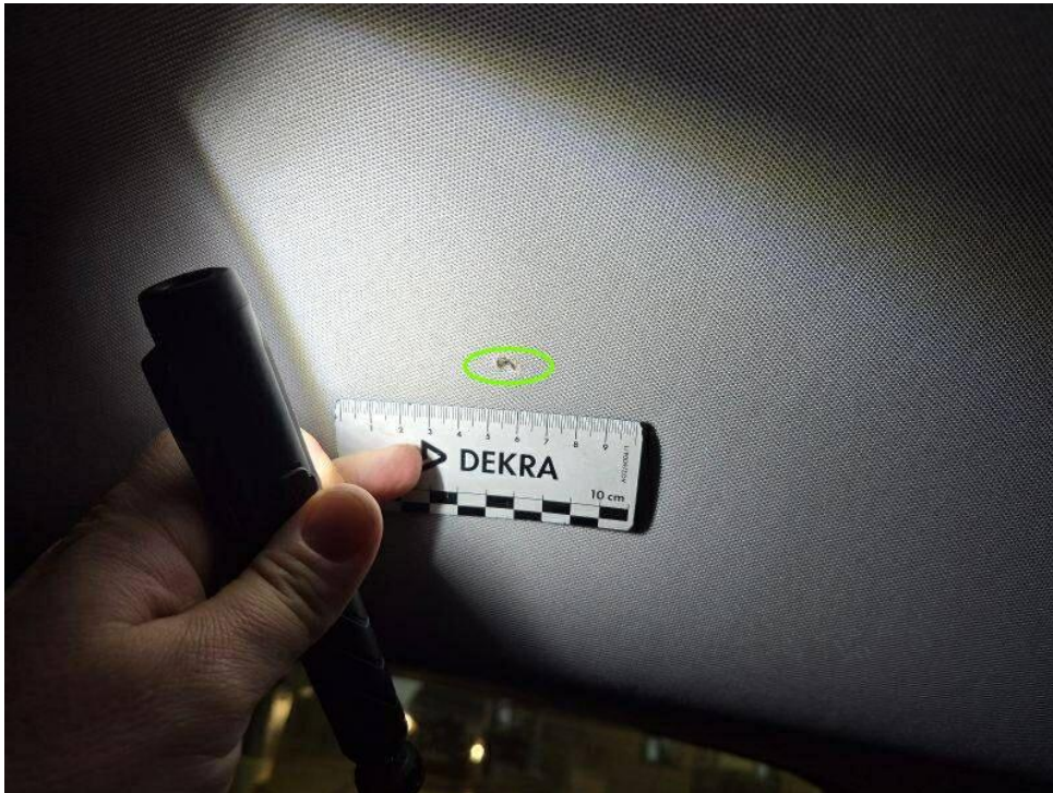
Bild 15 : Loch im Dachhimmel
