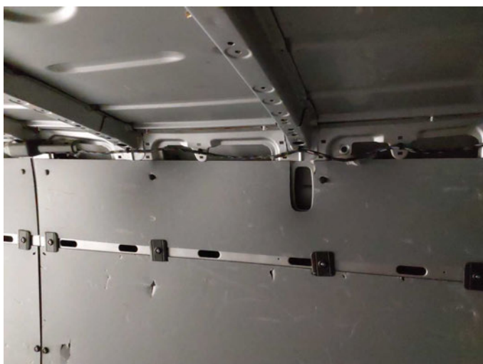
Beschädigung 45: Verkleidungen/Abdeckungen: Verkleidungen/Abdeckungen - fehlt - kein Abzug
