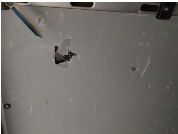
Beschädigung 49: Seitenwand links: Innenverkleidung - Löcher - kein Abzug
