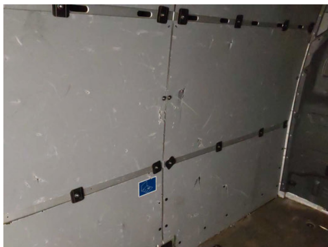
Beschädigung 49: Seitenwand links: Innenverkleidung - Löcher - kein Abzug
