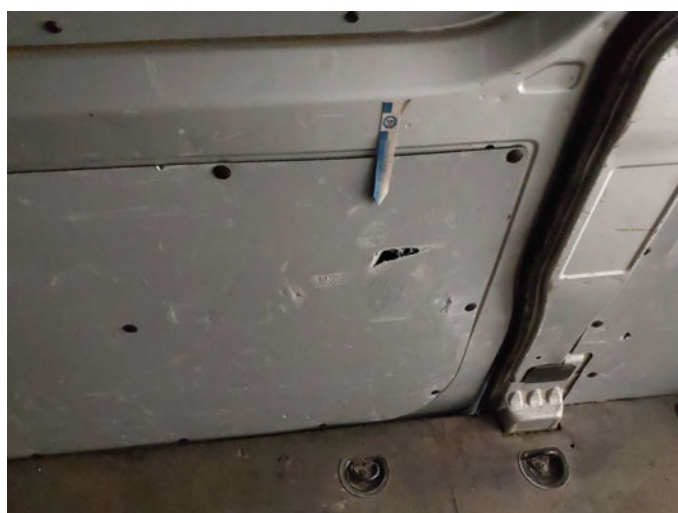
Beschädigung 43: Schiebetür rechts: Verkleidung Standard unten - Löcher - kein Abzug
