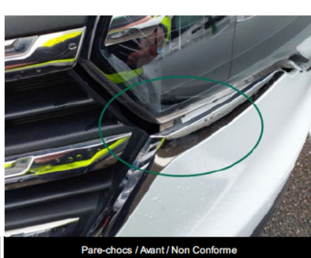
Pare-chocs / Avant / Non Conforme
