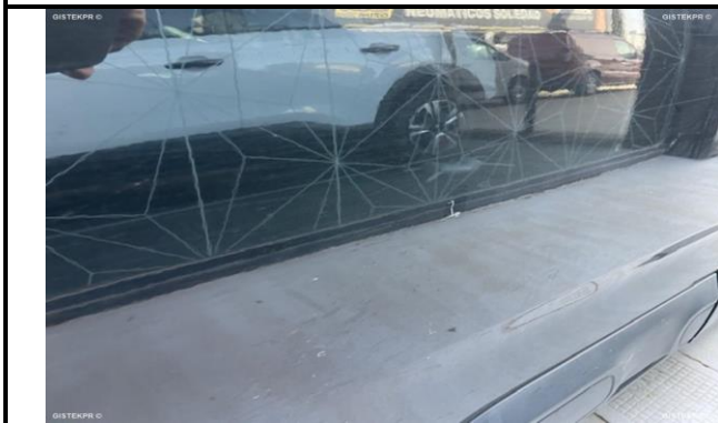
Foto daños externos 1
