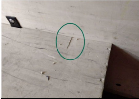
Abdeckung / Hinten Links / Gebrochen
