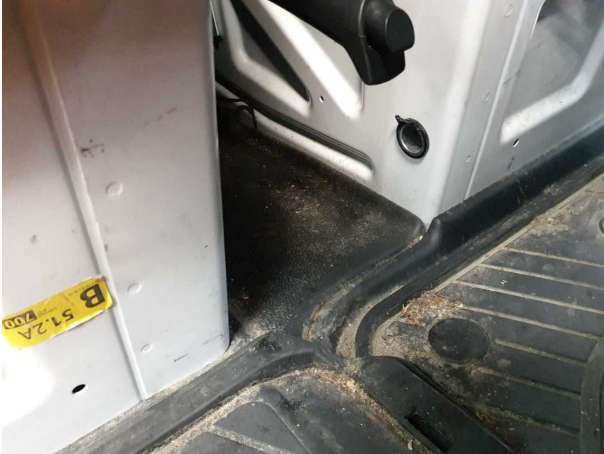
Beschädigung #1: elektrisches System: Steckdose - beschädigt - erneuern
