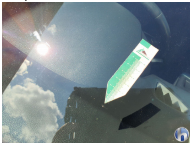
1. Windschutzscheibe Steinschlag - Smart Repair
