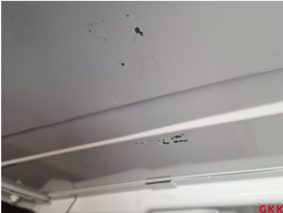
Bild 42. Dach, innen, beschädigt, Smartrepair
