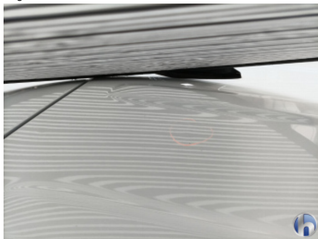
1. Dach Hagelschaden - Sanft Instandsetzen
