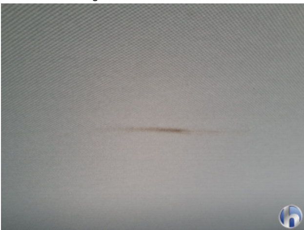
10. Dachhimmel Verschmutzt - Reinigen
