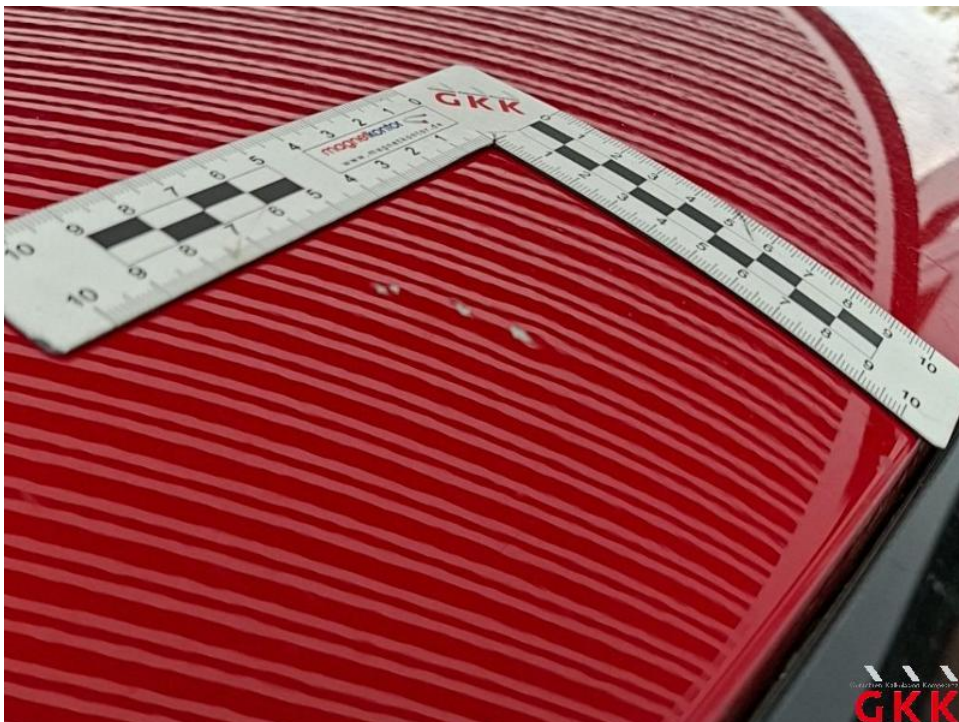
Bild 40. Dach, beschädigt, instand setzen - lackieren
