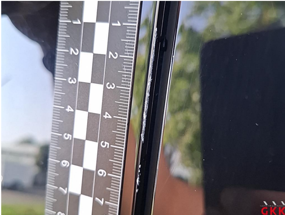
Bild 24. Tür vorne links, Blende -Fensterrahmen-, verkratzt, ersetzen
