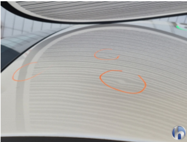
4. Dach Dellen / Beulen - Sanft Instandsetzen
