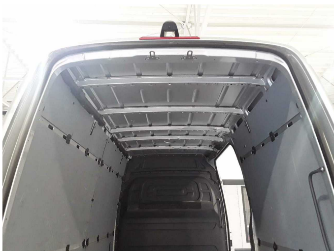
Beschädigung 29: Verkleidungen/Abdeckungen: Dachverkleidung Mitte - entspricht nicht den Herstellervorgaben - instandsetzen und lackieren
