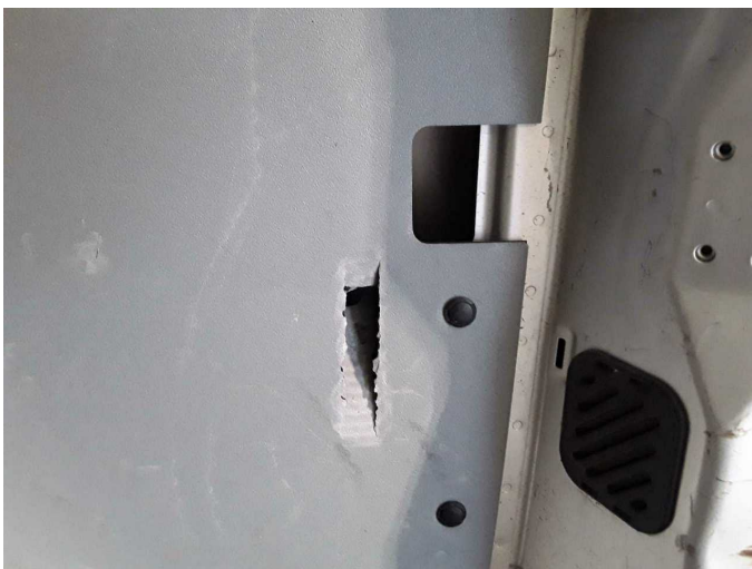
Beschädigung 27: Verkleidungen/Abdeckungen: Laderaumverkleidung rechts - gebrochen / gerissen - erneuern
