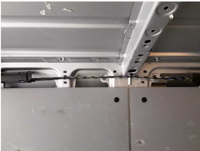
Beschädigung 25: Seitenwand links: Innenverkleidung - fehlt - erneuern
