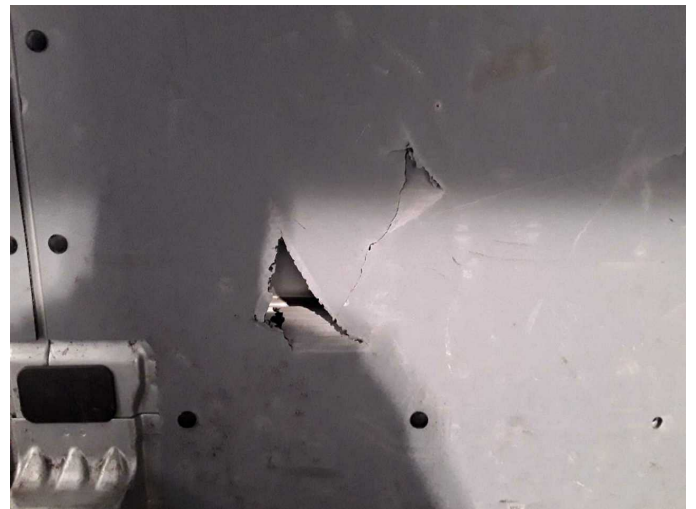
Beschädigung 26: Verkleidungen/Abdeckungen: Laderaumverkleidung links - beschädigt - erneuern
