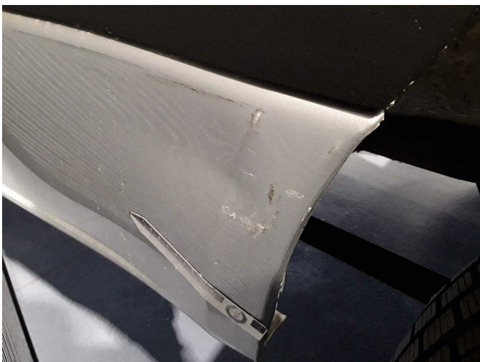
Beschädigung 4: Schweller links: Schweller - beschädigt - erneuern
