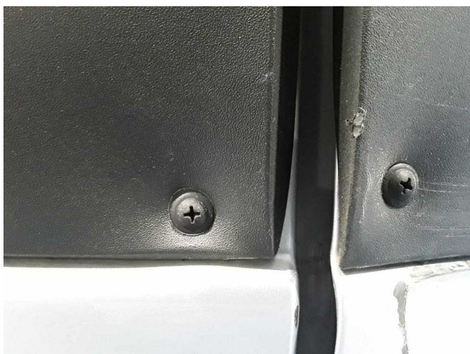
Beschädigung 12: Seitenwand rechts: Schutzleiste - beschädigt - erneuern
