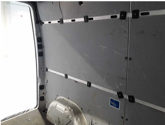
Beschädigung 26: Verkleidungen/Abdeckungen: Laderaumverkleidung links - beschädigt - erneuern
