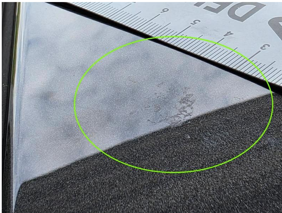
Bild 25 : Dach Lackierung, Umweltschaden, lackieren
