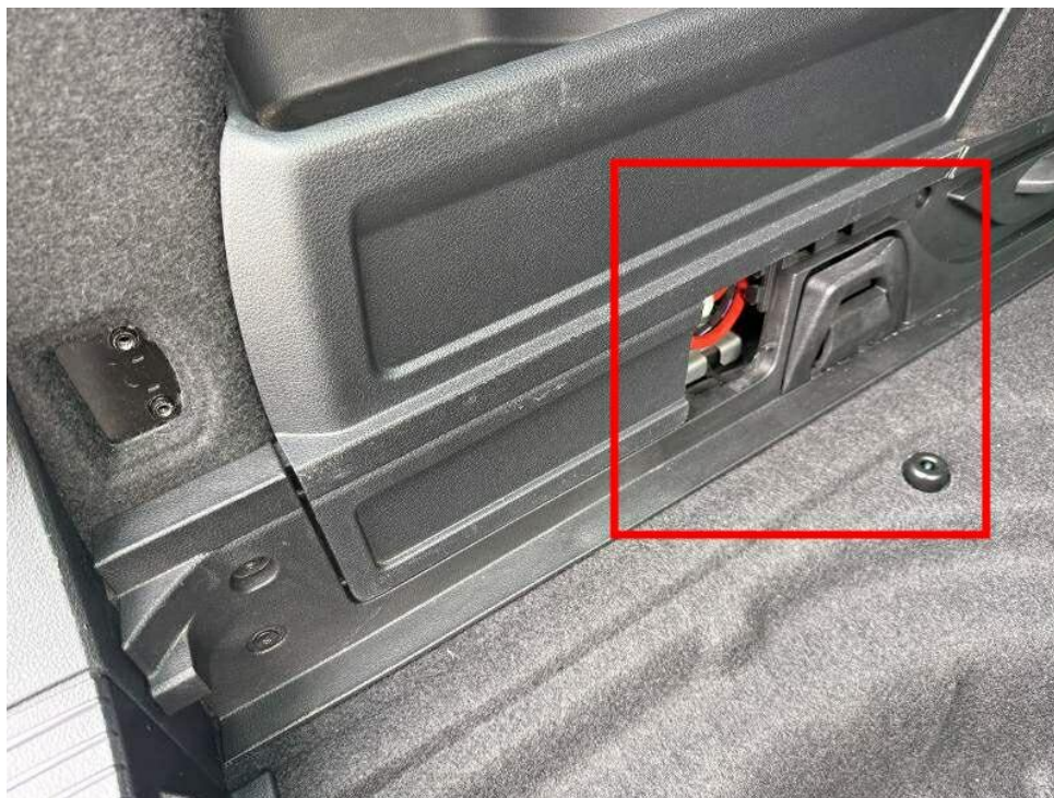
Bild 21 : Verkleidung im Kofferraum links beschädigt
