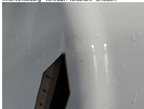
Beschädigung #2: Seitenwand links: Einstieg - Kratzer - Smart Repair
