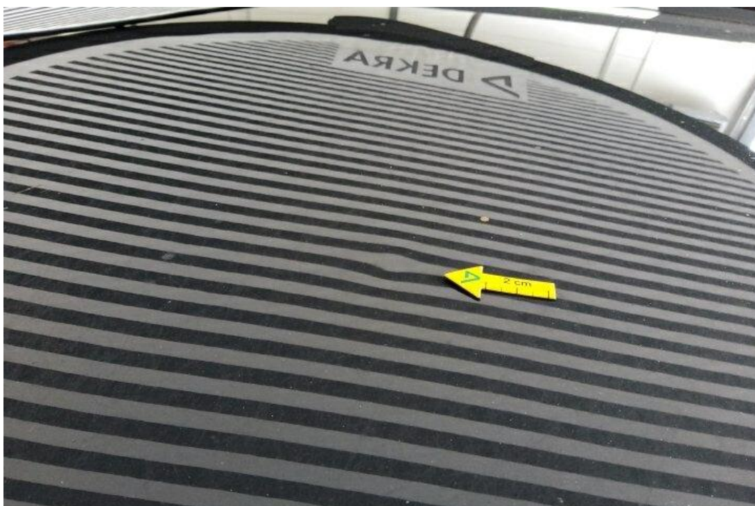
Bild 16 : Dach, eingedellt, drücken
