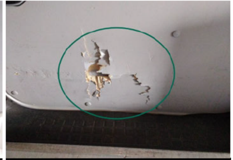
Innenverkleidung Laderaum / Unten Vorne Rechts / Gebrochen
