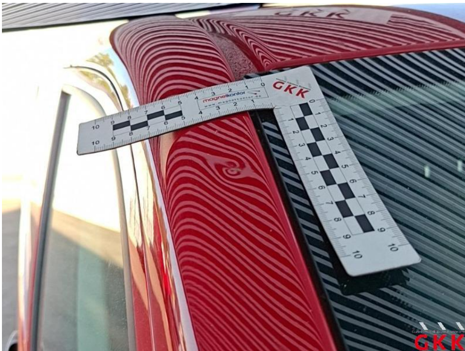
Bild 36. A- Säule rechts, beschädigt, instand setzen - lackieren
