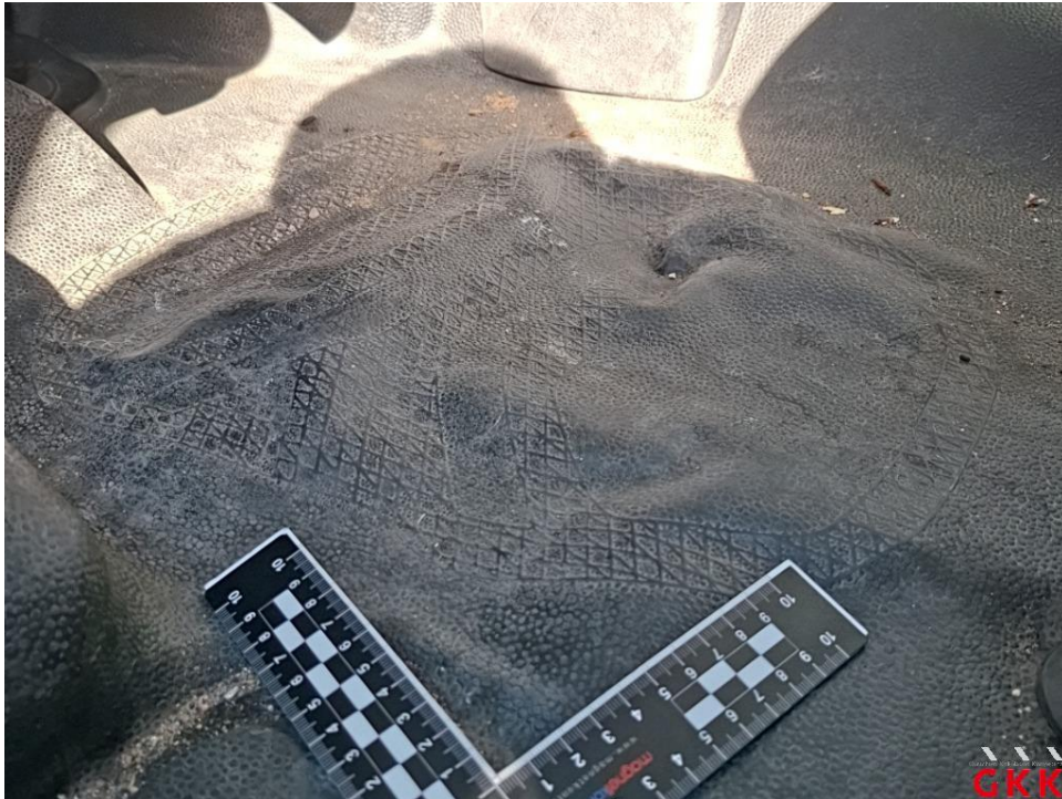
Bild 29. Fahrerhaus, Bodenbelag, beschädigt, ersetzen
