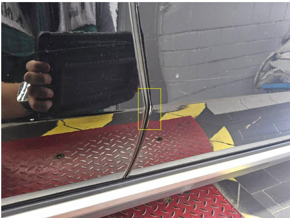
Bild 28 : Tür vorne rechts, eingedellt, instandsetzen und lackieren mit Lackaufbau
