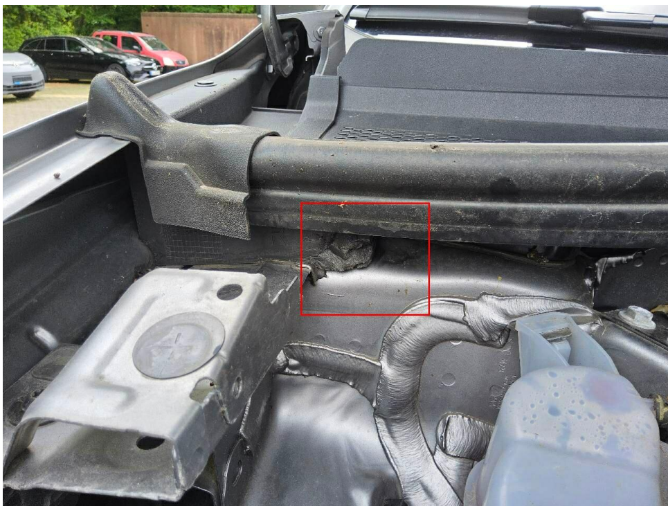
Bild 8 : Motorraum Dämmmaterial Tierbisse
