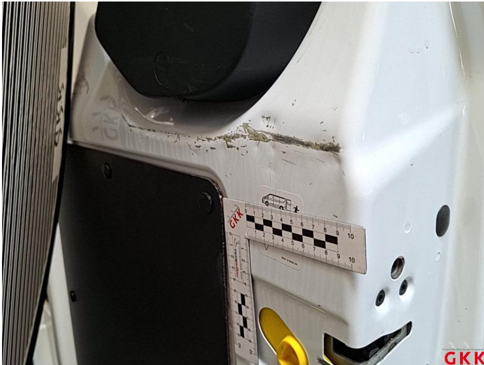
Bild 31 Hecktür rechts, innen, beschädigt, instand setzen - lackieren
