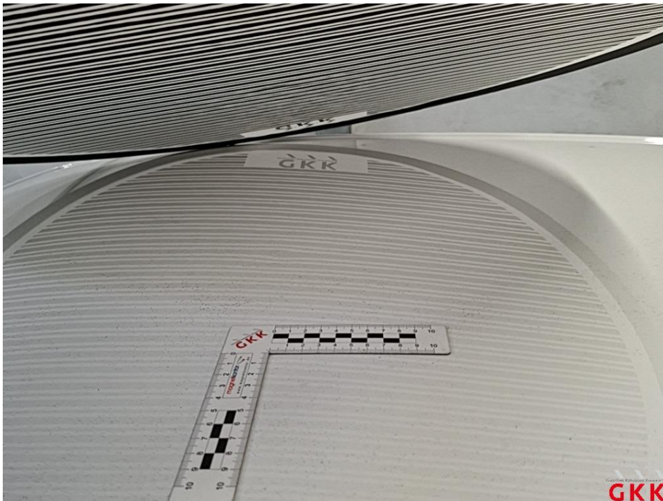
Bild 14 Dach, beschädigt, kalt drücken
