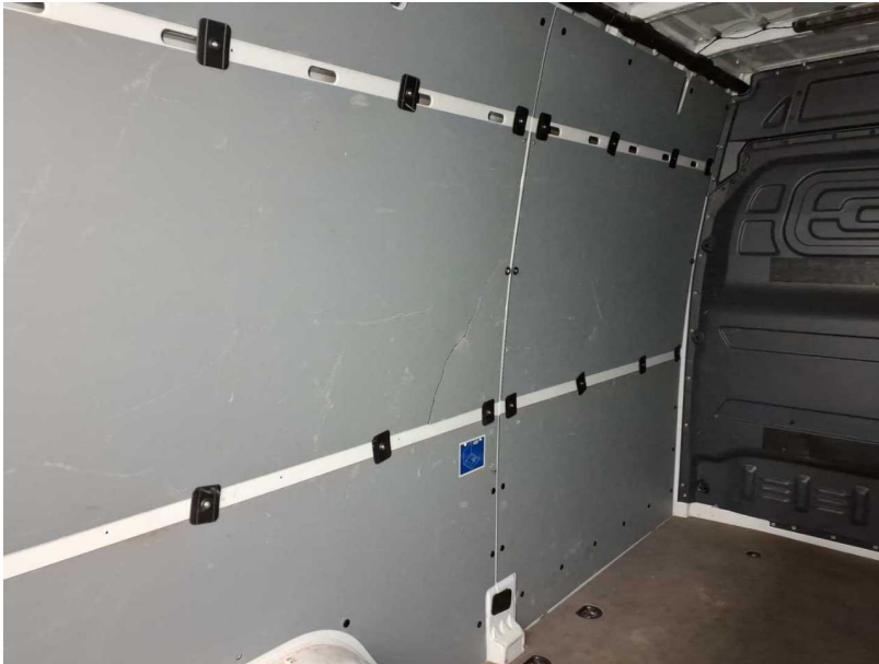
Beschädigung #35: Verkleidungen/Abdeckungen: Laderaum (10x) - gebrochen / gerissen - erneuern
