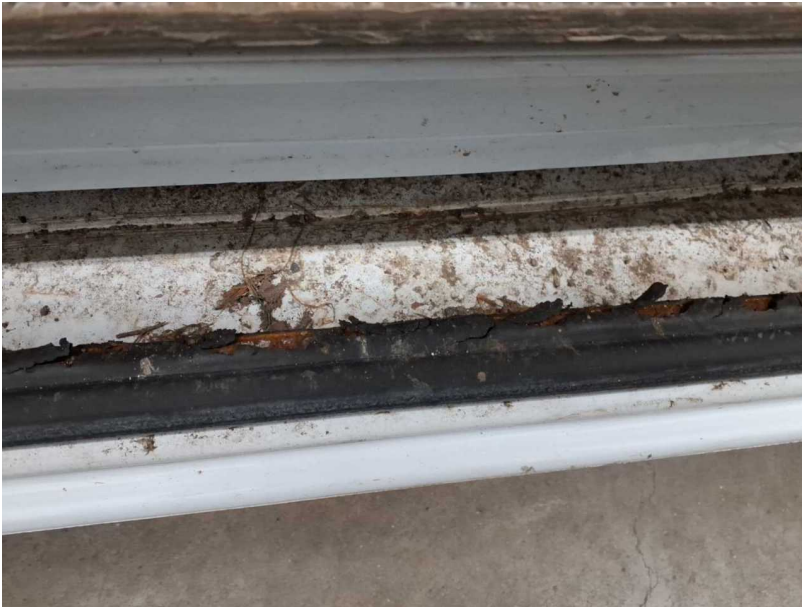
Beschädigung #7: Schiebetür rechts: Türdichtung - gebrochen / gerissen - erneuern
