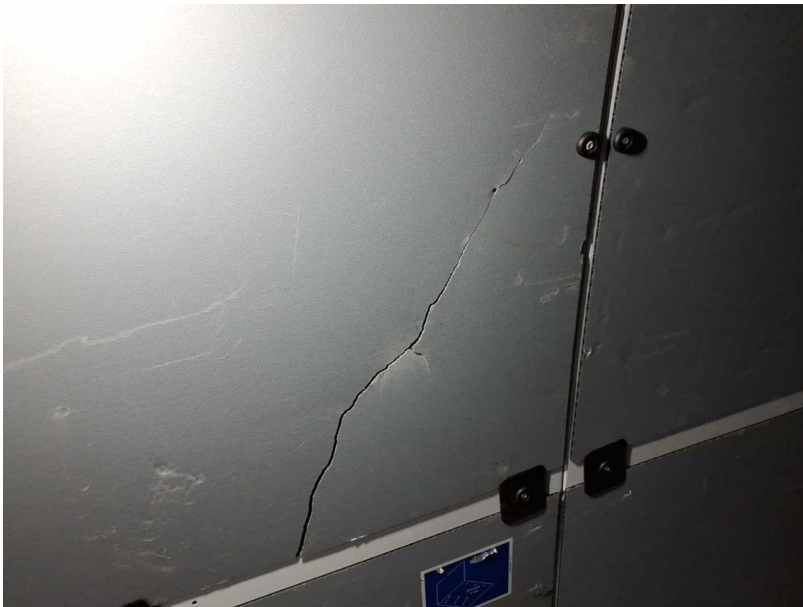
Beschädigung #35: Verkleidungen/Abdeckungen: Laderaum (10x) - gebrochen / gerissen - erneuern
