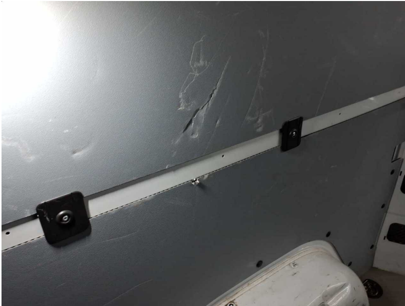
Beschädigung #35: Verkleidungen/Abdeckungen: Laderaum (10x) - gebrochen / gerissen - erneuern
