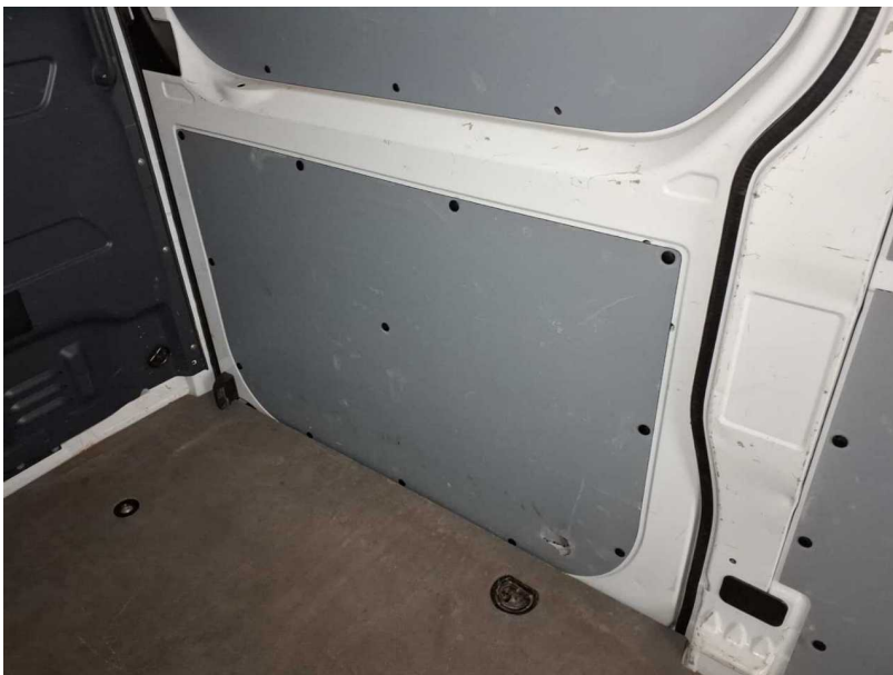
Beschädigung #35: Verkleidungen/Abdeckungen: Laderaum (10x) - gebrochen / gerissen - erneuern
