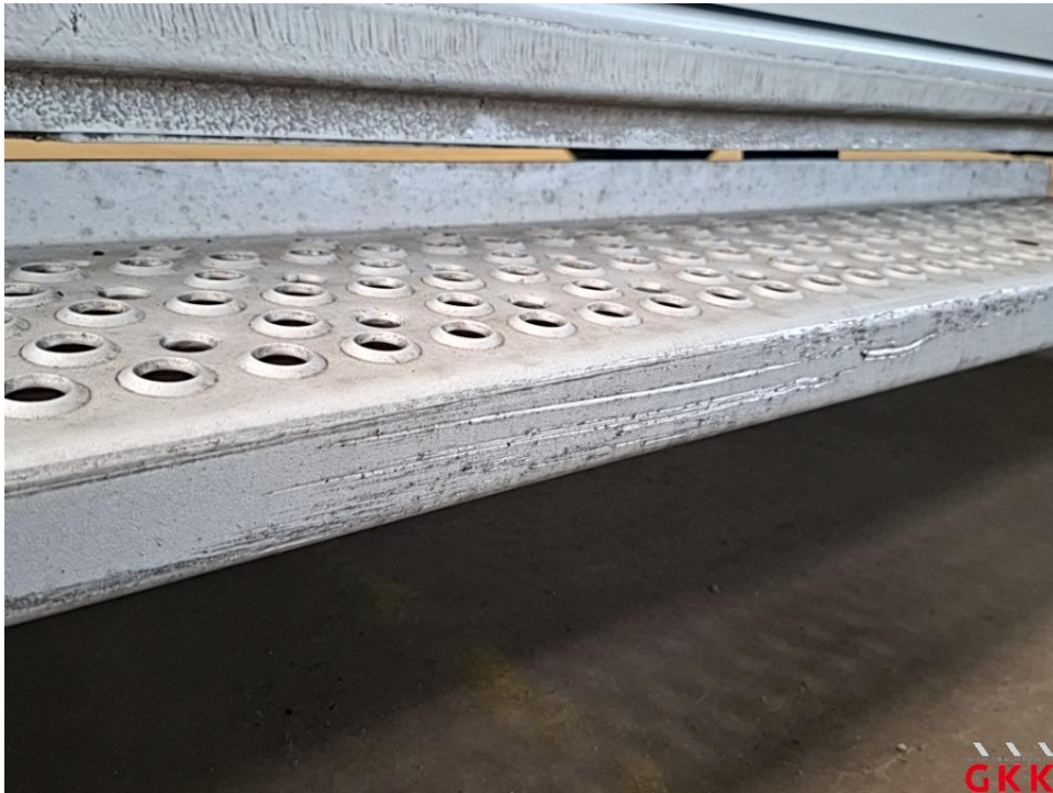
Bild 39 Trittbrett, verkratzt, ersetzen
