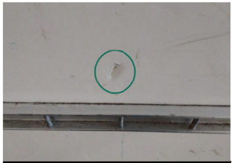
Seitenwand / Rechts / Gebrochen
