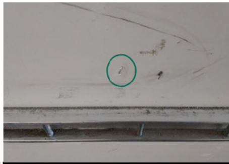
Seitenwand / Rechts / Gebrochen
