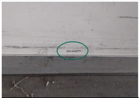
Seitenwand / Rechts / Gebrochen
