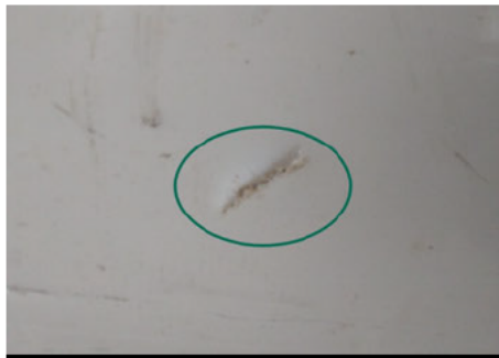
Seitenwand / Rechts / Gebrochen
