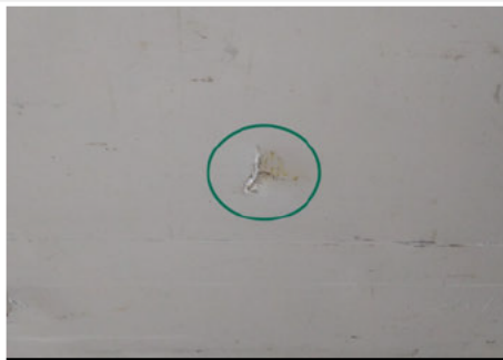
Seitenwand / Rechts / Gebrochen
