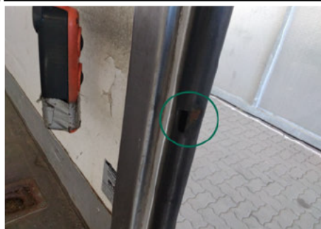
Dichtung Türeinstieg / Hinten Rechts / Gebrochen
