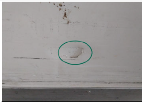
Seitenwand / Rechts / Gebrochen
