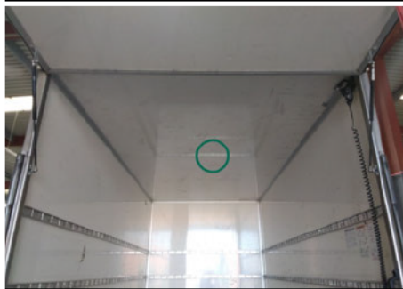
Dach / Hinten / Gebrochen
