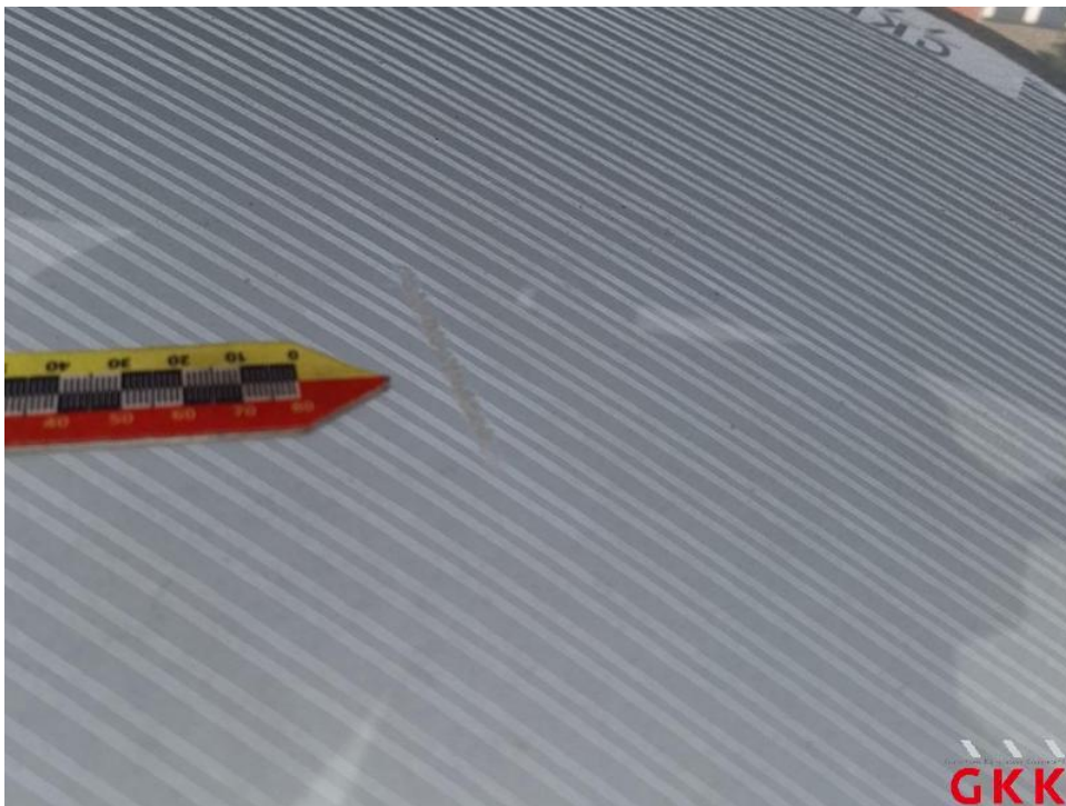
Bild 28. Dach, verkratzt, lackieren
